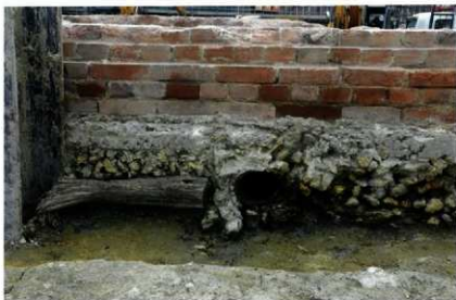
3号遺構排水口 北東より コンクリート基礎より数cm出ている。木材は型枠？
