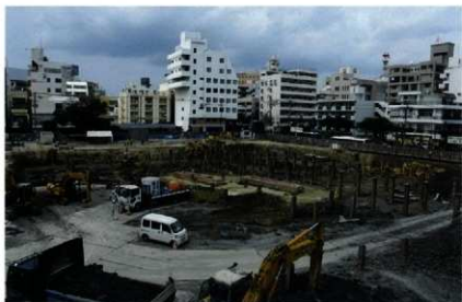
調査地遠景 南より 2・3号道構は工事中の敷地内中央に位置する。
