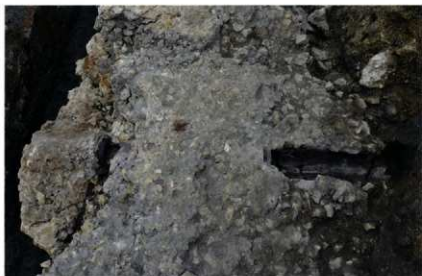
排水溝（陶管）西より レンガ積み基礎下の陶管はコンクリートで覆われている。
