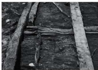
⑮ 材4 破断状況
