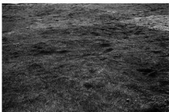
Fブロック窪み検出状況 北西から
