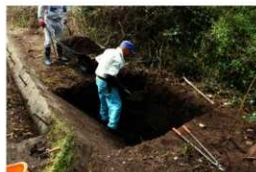
写真 46: 第2トレンチ外側(前室・奥室変換点箇所)の擁壁外側の掘り下げ状況
