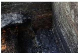
④ 4号掩体壕第1トレンチ状況 擁壁基礎最深部への杉板表面付着の状況
