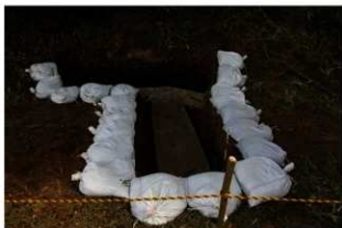
⑥ 2号掩体壕の環境整備 オープン部への安全ロープ設置と土壌による 縁辺部補強状況
