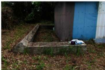
写真 45: 3号木製有蓋掩体壕の前室左袖部コンクリート露出状況
