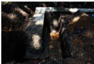
② 4号掩体壕第1トレンチ状況 袖部と擁壁基礎部の状況
