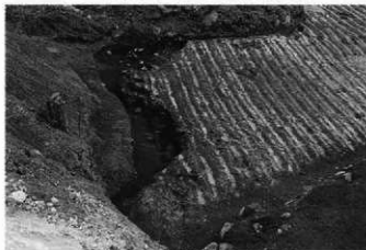
5. N26 畑南端部崩落状況（東から）
