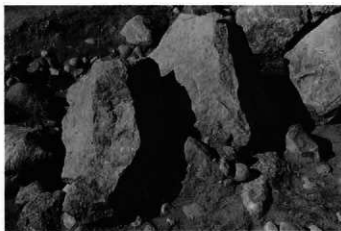
1. 石室：天井石崩落状況（東→）
