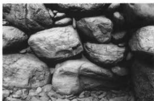
2 石室石材の割れ
