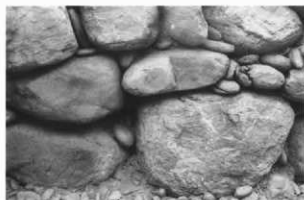
3 石室石材の割れ
