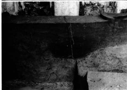
調査区西壁 第8a・b層に貫入する 噴砂 (東から)
