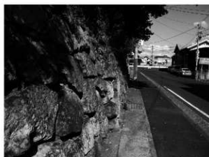
第5図 石垣の変形状況
