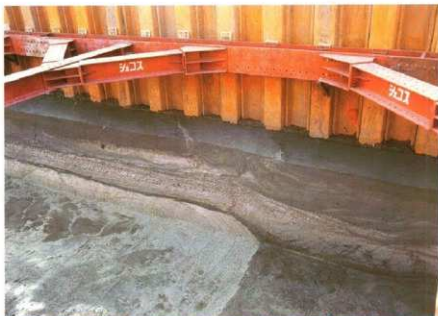
第4層の噴砂・亀裂 (北東から)
