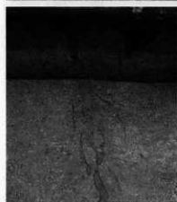
8. 地割れ (噴砂): f④ (2区・南より)
