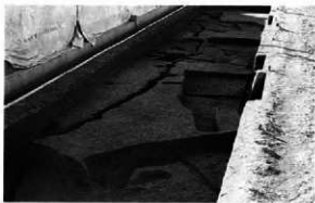
1. 地割れ：k (2区・東より)
