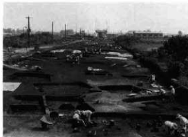
▲4～5区の奈良・平安時代の調査(北から) 橋脚は2区の本線敷部分。3～5区は南北300mの区画。
