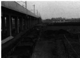
▲2区西側道掘削全景(北から) 2区の本線敷は未調査で、東西の側道敷は二次調査で発掘した。
