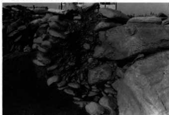
3 羨道左壁の裏込め状態
