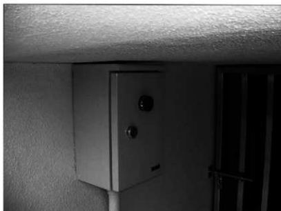
スイッチボックス取付状況
