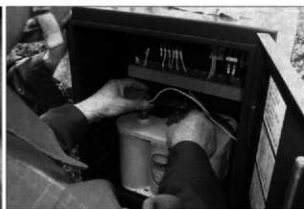
バッテリーの配管状況
