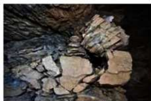
玄室前道袖石の割れ
