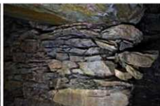
玄室前道袖石の割れ
