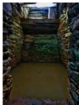
石室滯水状況
