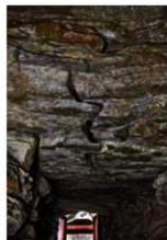
玄室前道天井石の割れ
