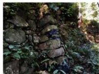
図 119 一部の石材が散失した石垣 (石垣 69)
