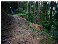
図 123 崩壊した曲輪法面
