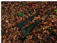
図 152 排水機能のないU字側溝
