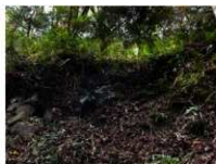
図 127 土砂流出発生箇所 (石垣 69)
