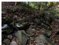
図 118 崩壊が進んでいる石垣 (石垣 89)
