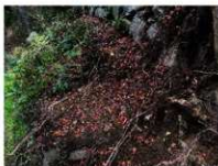
図 120 獣害により土砂が流出した 石垣(石垣 6・7)
