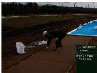
R1 園路舗装工（周遊路）透水性スラグ舗装 コテ仕上げ状況
