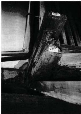
腐朽した出格子梁木
