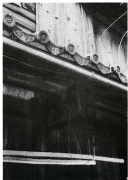
切断された差鴨居
