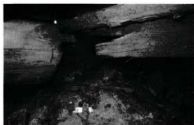
柱が欠損し基礎に絡む床組
