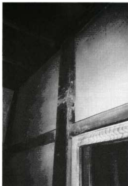
柱、ぬノ9・不一致の細工跡
