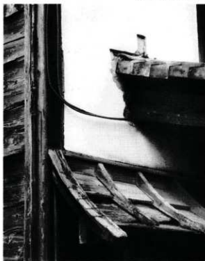
破損した正面戸袋
