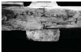
下面が腐朽した地樑
