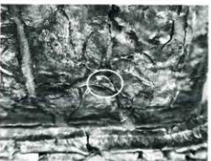
剥落箇所が判明した塗膜片
