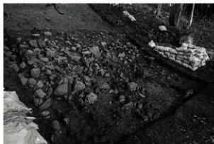
写真7 石垣 SW020102 崩落状況
