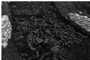
写真5 石垣 SW020101 崩落状況 (上層)
