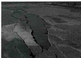
写真3 西宮市内の海岸に沿って生じた地割れ群 (地割れの一部から噴砂が流れ出している)
