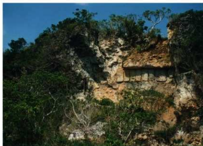
図版 1. 斜面崩落箇所近景（東側より）
