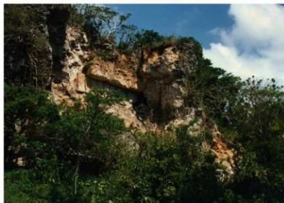
図版 2. 斜面崩落箇所近景（西側より）
