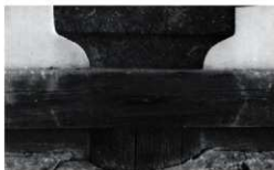
Fig.VI-8-4 薬師寺東塔 台輪金具の当たり痕跡
