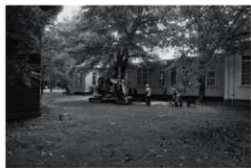
A、ワイン研修センター改修室外機基礎その他敷設工事（北西より）調査番号：2205
