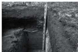
F、ワイン研修センター改修室外機基礎その他敷設工事 TP04（南より）調査番号：2205
