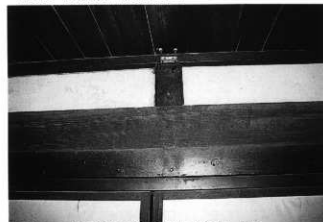
写真83 庫裏前列土間境の部屋の切断された柱
