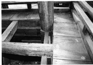
写真327 鐘樓上層と床板のない内部
