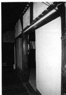
写真97 庫裏背面片引戸の痕跡
