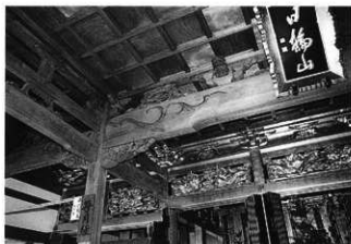
写真291 本堂外障後補の虹梁
