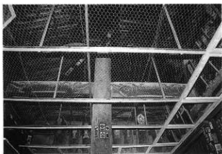
写真13 講堂外障入隅柱部分
