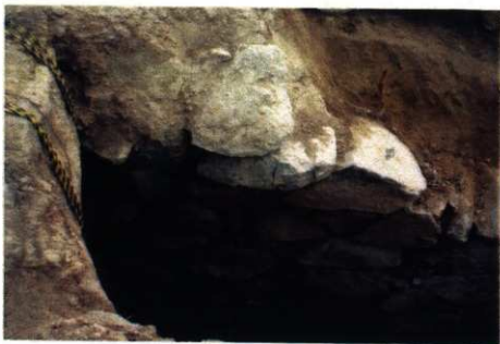
玄室左側壁面袖部崩落状況（西から）
