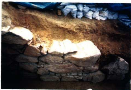
同羨道部崩落状況（西から）
