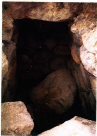
同石室内天井石落下状況（南から）
