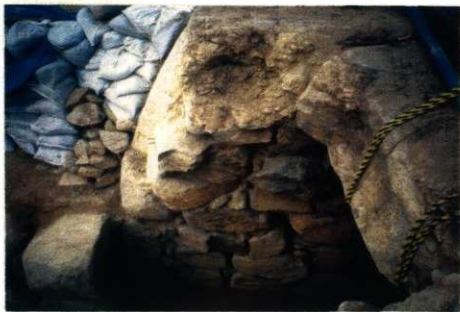
玄室右側壁面袖部崩落状況（東から）
