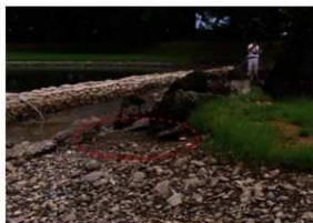
【写真 3-2-75】 第1期州浜（立石の北西）欠損箇所
