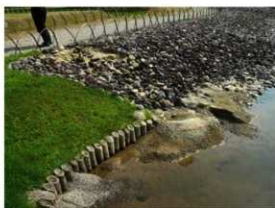
【写真 3-3-1】 州浜の崩れと土砂の流入状況
