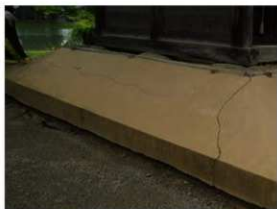
[写真 3-4-48] 鐘楼 / 亀腹の亀裂 (平成 24 年 9 月)
