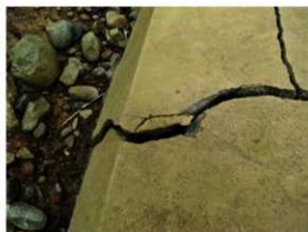
[写真 3-4-49] 鐘楼 / 亀腹の亀裂 (平成 24 年 9 月)
