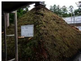
[写真 3-4-46] 鐘楼 / 茅葺き屋根の傷み (平成 26 年 7 月)
