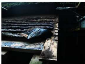
[写真 3-4-21] 下地材の損傷状況
