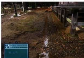
[写真 3-5-12] 常行堂西側 雨落ち修理前
