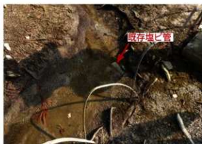
[写真 3-5-27] 常行堂南側既存素掘り側溝 土砂堆積状況
