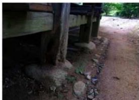
[写真 3-4-44] 常行堂北面 / 縁束の腐食と蟻害状況 (平成 24 年 9 月)
