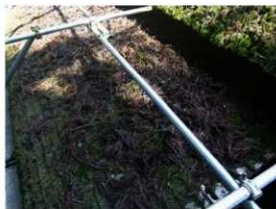
【写真3-4-2】下屋庇に堆積した杉枝と苔の活着 (平成26年7月)
