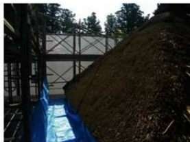
[写真 3-4-47] 鐘楼 / 茅葺き屋根の傷み (平成 26 年 7 月)
