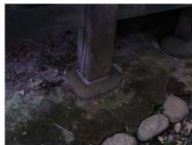
【写真3-4-3】常行堂北面/縁東鉛板のずれ (平成24年9月)
