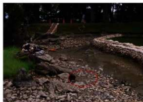
【写真 3-2-76】 第1期州浜（立石の南西）欠損箇所
