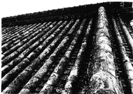
図版10 斑鳩寺講堂 修理前 背面西半分の屋根 (葺瓦はかなり破損し、葺足も弛んでいる。)
