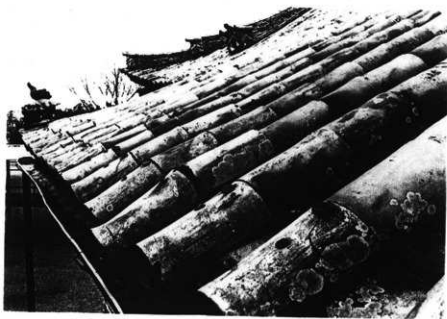
図版 6 斑鳩寺講堂 修理前 向拜の屋根軒端の状況 (軒巴瓦がずれさがっている。)
