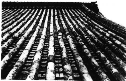
図版 5 斑鳩寺講堂 修理前 正面屋根の状況 (葺瓦に破損がみられ、葺ずれが著しい。)
