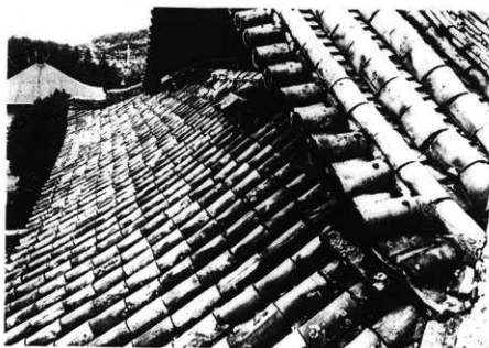
図版 8 斑鳩寺講堂 修理前 西面屋根の状況 (葺きずれが著しく雨漏りしている。)
