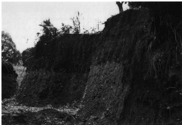
国鉄伊丹駅前整備事業主郭石積み工事立会 切り土の状況
