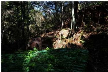
R5年度施工箇所上部 樹木根の腐食による崩落及び、花崗岩円礫の転石危険箇所
