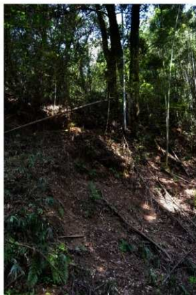
F 地点東側 法面上部の樹木 ( 風の作用で地面が揺らされ崩落の可能性あり )
