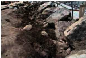
裏込め 目づまりをおこした状態 東から
