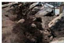
① 裏込め目詰まりの状況
