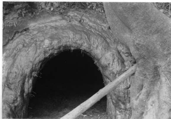
図版32 30号横穴「発泡ウレタン吹き付け後のFRP貼り付け状況」
