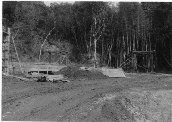
図版86 竪穴住居、高床倉庫建設工事(御諏訪池西岸支谷建設)
