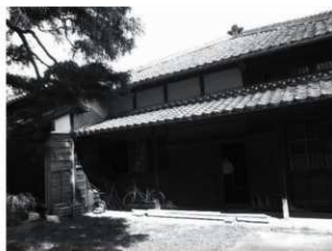
・主屋正面：右側より見る。 小壁は白色。切返し塗りに混ぜられた漆喰が 浮き上り、黒壁が白壁に変色。
