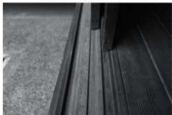
・主屋棟西縁先敷居: 溝を建具が移動。恐らく竣工時には明障子であったので、溝を埋木程度の処理としたであろう。
