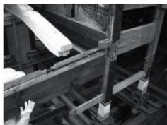
・蟻害で取替た小屋梁：松丸太 へ通り 13-16
