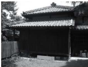
・主屋棟正面左側：正面から見る。 右端の窓は洋間の窓。窓硝子のパテ止めの 白線が見える。
