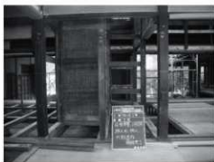
・柱「ね-18」と柱「ね-20」：両柱には壁の痕跡が残存。柱「ね-19」は半柱で、ね通り壁を受ける。
