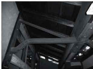
・「離れ」1階東縁側上部：2階張り出しの縁側 を支える補強持ち送り鉄材。旧縁軒桁の先まで 延びる2階縁を支える。
