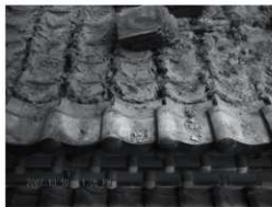
・主屋上土葺き下地: 葺き土の量が多い。
