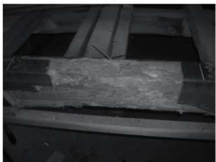
・蟻害を受けた台所・ひろま境板間上框の修理1 材種は松。取り外して被害量を確認。被害箇所を荒取りする。
