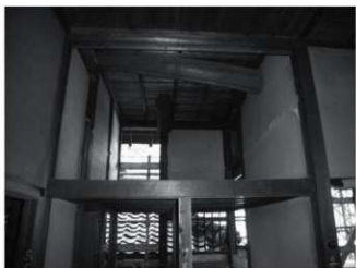
・同2階納戸：鴨居上方の柱に旧天井廻縁欠込み。 右壁の上方同位置に塗り違い傷。後補工事？
