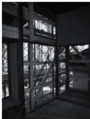
・「離れ」2階控えの間：柱が真近に2本並ぶ？ 右の柱は半柱に欠取られている。後補工事？
