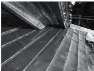
・「離れ」2階銅板平葺き屋根 銅板重ねの先端を鉋で浮かせ、桧皮葺きの質感を出す工法を採用。施工業者は限られる。
