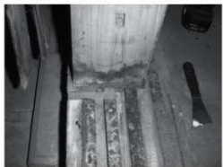
・3本敷居と柱「ぬー7」: 錆びた鉄板。外部の一筋敷居(雨戸用)の極端にも鉄板が見える。
