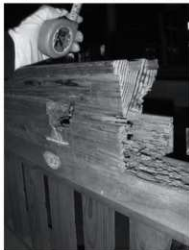
・蟻害を受けた敷居 ：凸型埋木が見える。第2節に掲載の修理材。
