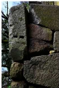
南東隅角部周辺 表面に埋がついたような風変 石材の裏面が層状に剥離
