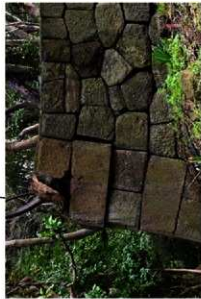
南西角石 空も柱れた樹木根が露る 周辺には駆落した角石材は見当たらない
