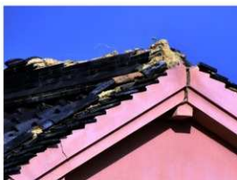
鬼瓦や棟瓦の被害
