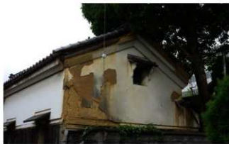
経年劣化によって損傷した外観
