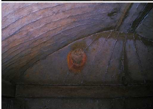
3. 宿横穴群ST-009 玄室天井右側妻部 リング状赤色部
