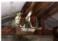
[写真 2-16] 石廟内部応急処置前
