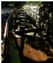
[写真4-9] 築地堀倒壊状況
