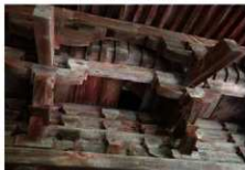
[写真4-8] 三重塔初層の傷み状況
