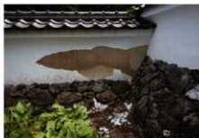
[写真4-1] 上段南側土塀の壁剥離
