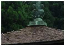
[写真4-7] 三重塔屋根根廻り損傷状況（差し込み銅板の露出）
