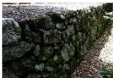
[写真4-4] 上段石積のはらみ
