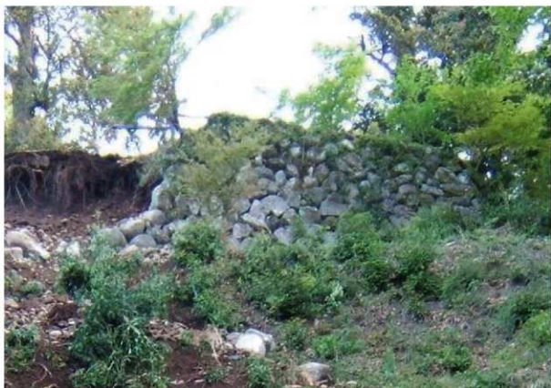
②石垣 10 被災状況
