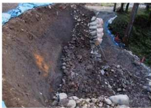
④裏止め石列消失 背面は凝灰岩岩盤
