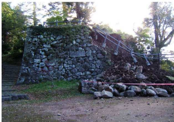
②石垣 被災状況
