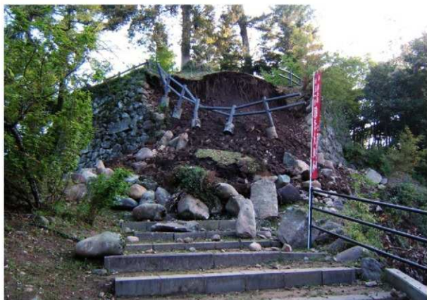
②石垣 9・10 出角部 被災状況
