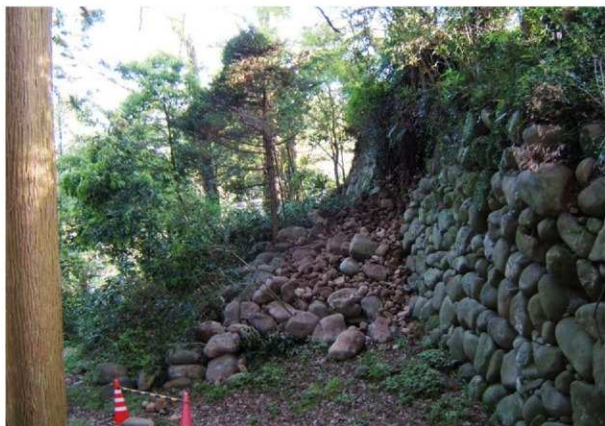
②石垣2 被災状況
