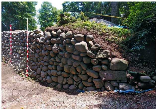
①石垣 2-2 解体前孕み状況
