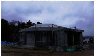
PCaとPCの組み合わせによる保護施設。完全に脱枠も行った状態。
