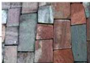
浮み出し箇所には縦方向の連続した目地の開き
