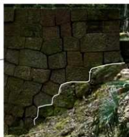
縦方向の連続した目地の開き (1~4.3cm) 2830Nと異なり、築石にも及び 最下部に江戸後期修築前の石積み
