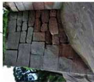
隅角部と旗石間に縦方向の連続した目地の開き
