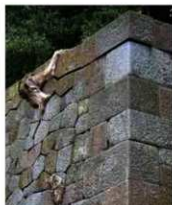
天端等の石面が乱れ、樹木根が築石の目地に入り込む
