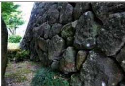
前倒れする変形を残したまま、上部の改修が行われたため、改修境で勾配が異なる
