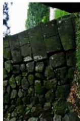
隅角部と表石部に縦方向の開き
