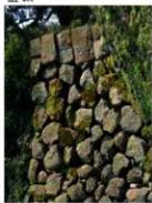
孕み出しが顕著な箇所 上層は後へ転倒する ように歪む
