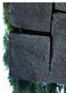
天端角石の突出し
