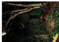
平成3年(1991) 角盛石の崩落前の状況
