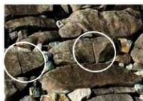
写真11 積み石の曲げ破壊の例
