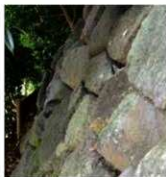
築石の迫出し、面的に前倒れした状態。さらに雨側は近代以降に撤去されており、その際に変形が生じた可能性がある
