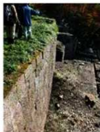
写真18 背面地盤の変状による前倒れ変形
