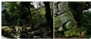
写真9 地形と石垣変形
