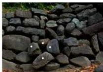
築石崩落前（北から）
