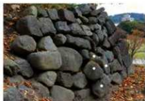
築石崩落前（西から） 築石が前に迫出し、上部からの荷重が少ない状況
