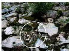
写真13 積み石の圧壊(せん断破壊)の例
