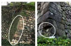
写真12 積み石の割裂破壊の例
