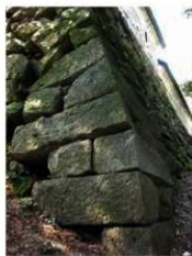
変形による稜線のずれ、斜面方向の滑りにより下部角石の石尻が上がり角度が水平
