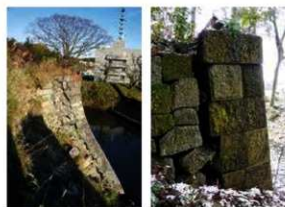
(a) 地震による前倒れ (b) 地盤の変状による前倒れ
