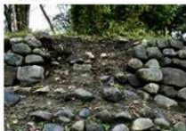
石材の崩落、雨水による背面土の流出
