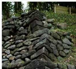
隅角部上2段の状況。下段の隅角部は算木積みで、 稜線は比較的通っているが、上段は角石が迫出し、 大きく前倒れ
