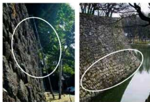
(a) 石垣中部のはらみ出し (b) 石垣下部のはらみ出し
