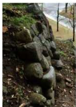
崩落部西側の下部の石が前倒れ 石材の控えが短く、裏込めが少ない
