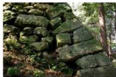
石積みの乱れと詰石の抜け
