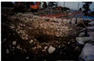
橋爪門統槽台 陥没坑検出状況
