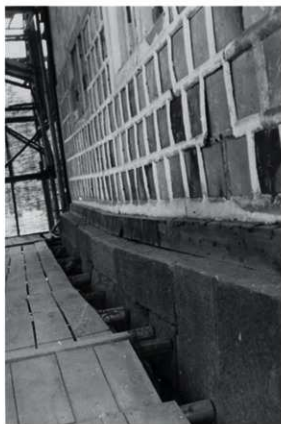
⑤石川繪 (南側) 石垣の沈下箇所
