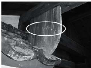
柄板の鉛の腐食痕跡と鉛板を留めていた釘痕
