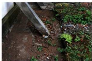
昭和修理コンクリート製土間破損状況 (調査前) 北から
