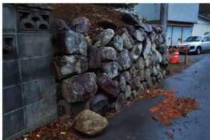
写真2 宮城県沖地震被害状況（東面）
