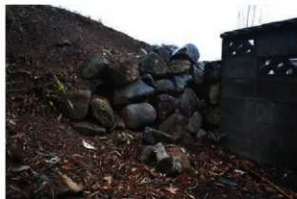
写真3 宮城県沖地震被害状況（南面）
