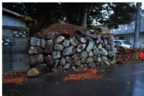
写真1 宮城県沖地震被害状況（東面）
