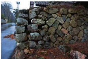
写真4 宮城県沖地震被害状況（北面）
