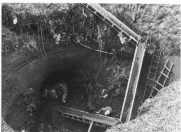
藤原式揚水車 2号機
