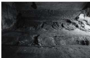
5. 掩体の平成 22 年豪雨被害状況(内部右側)
