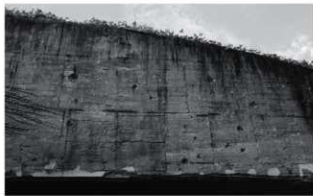
7. 掩体前壁に残る被弾痕跡
