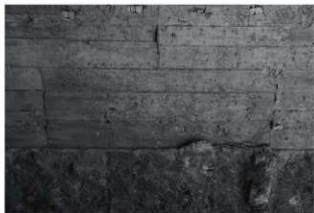
5. 掩体前部側壁に見える工法の違い 上部がZ6工法、下部がZ5工法
