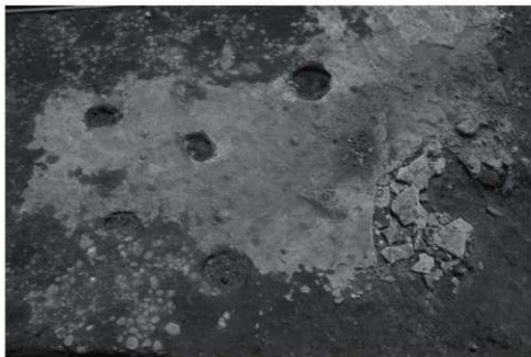
1. コンクリート敷に残る機銃掃射の被弾痕（西から）
