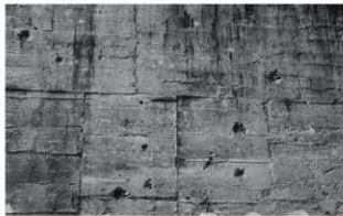
8. 掩体前壁の型枠跡と被弾痕跡
